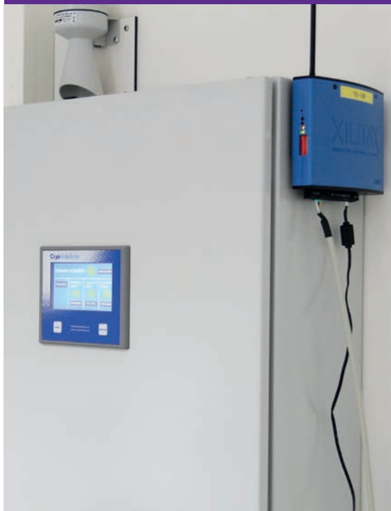
De infrastructuur van de nieuwe cryobank is voorzien van een moderne PLC-besturing en koppelingen naar het alarm-monitoring systeem Xilatrix.
